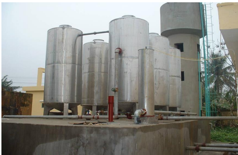
Xây dựng trạm cấp nước tại trung tâm điều dưỡng thương binh nặng Hà Nội
